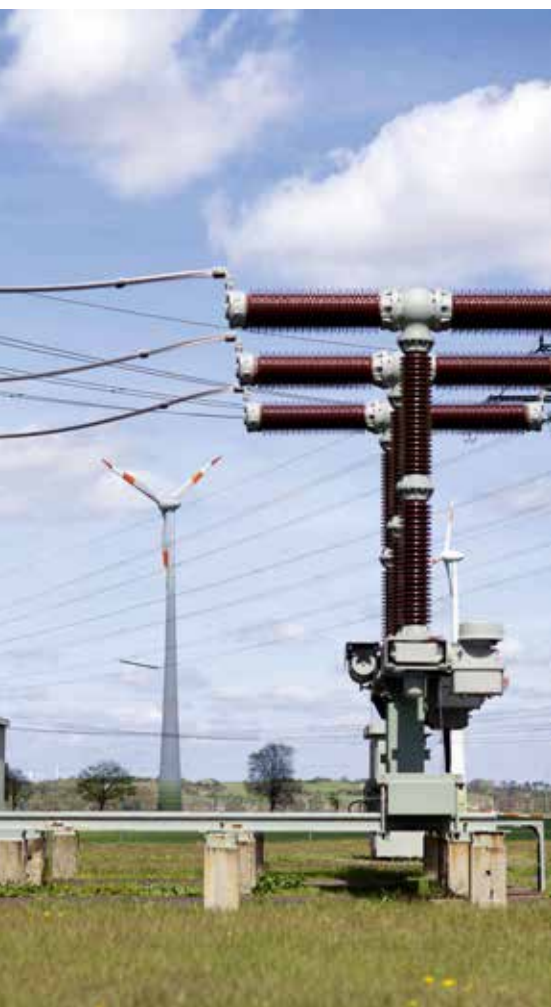
Leistungsschalter schützen nachgeordnete Anlagen vor Schäden durch Überlast oder Kurzschluss
